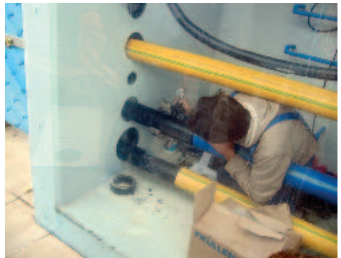
Saubere Arbeit: Bei Reparaturen können die Leitungen vom Versorgungsschacht aus abgetrennt und ersetzt werden.
