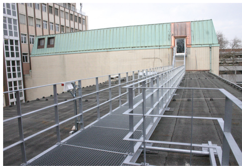
Keine Panik im Brandfall: Ein sicherer Steg führt ausgehend vom Großen Hörsaal übers Dach in ein anderes Treppenhaus.
