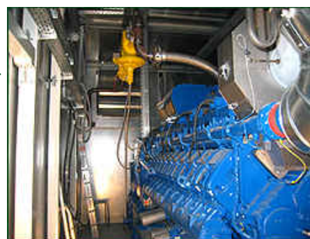
Blockheizkraftwerk (BHKW) Dresdner Straße
