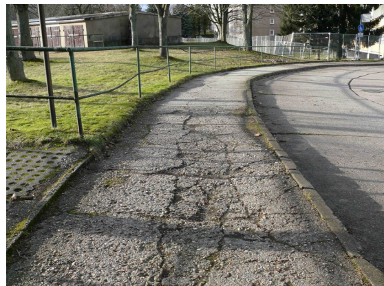
Fotografie 16: Reparaturbedürftiger Gehweg
