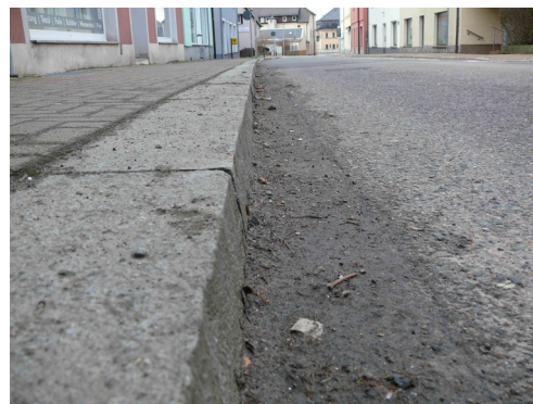
Fotografie 4: Bordstein Bahnhofstraße
