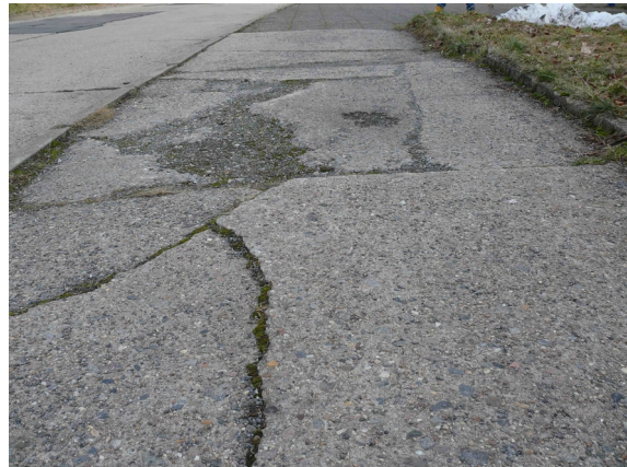
Fotografie 14: Risse im Gehweg
