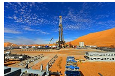
Bohrturm im Ölfeld El Merk, 2014
