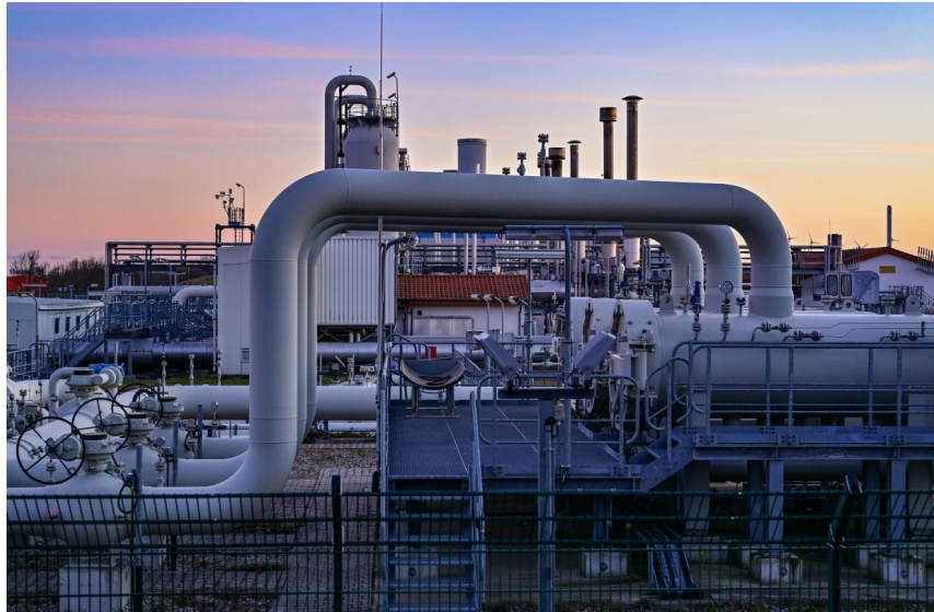
In der Verdichterstation in Mallnow wird das Erdgas der Pipeline „Jagell“ nahe der deutsch-polnischen Grenze verdichtet. Solche Verdichterstationen sind nötig, um den Druck konstant und das Erdgas transportfähig zu halten. (© picture-alliance, dpa/dpa-Zentralbild | Patrick Pleul)
