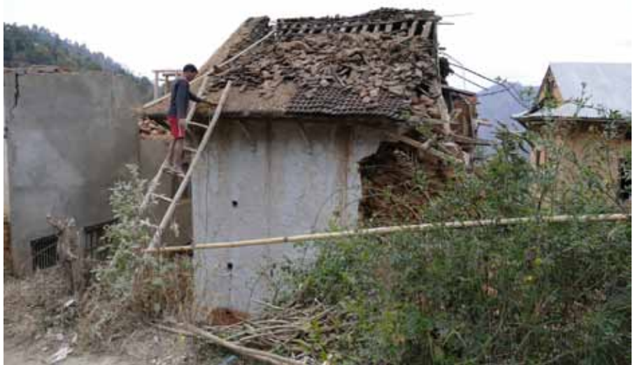
Mühsamer Wiederaufbau im Dorf Koshidekha – staatliche Mittel fließen viel zu langsam.
